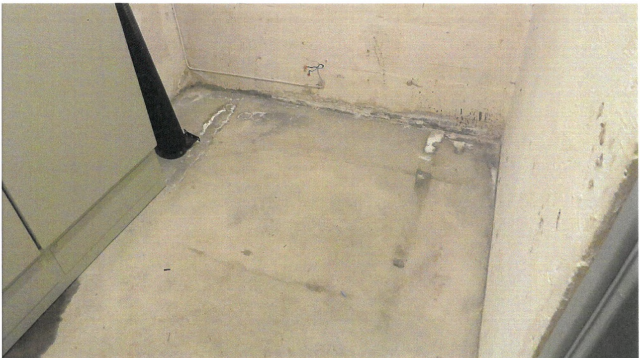
Foto 14: Fra kjellerrom i Bølerlia 127-131. Typiske tegn på kalkutfelling på gulvet. Dette skyldes kapillært fuktoppsug fra grunnen.
