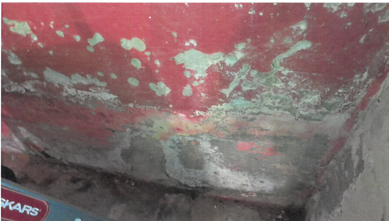
Foto 19: Typisk tegn på malingsavflaking og kalkutslag på vegg i et rommene i kjelleren på nr. 66-72.
