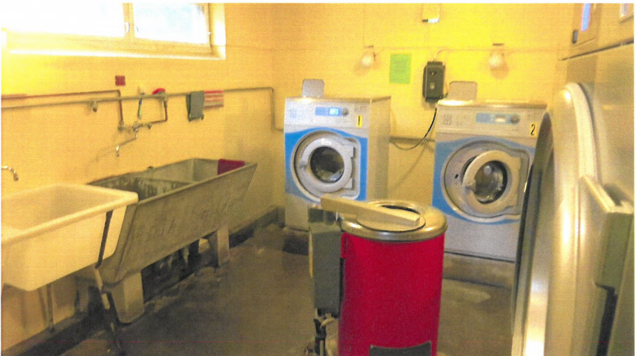
Foto 8: Fra kjelleren i 117-125. Vaskerommet i østre ende av bygget (nr. 125). Ser ut til å fungere bra. Noe avflaking av maling på deler av gulvet. Skyldes trolig fukttoppsug fra grunnen, men kan også skyldes brukspåkjenninger.
