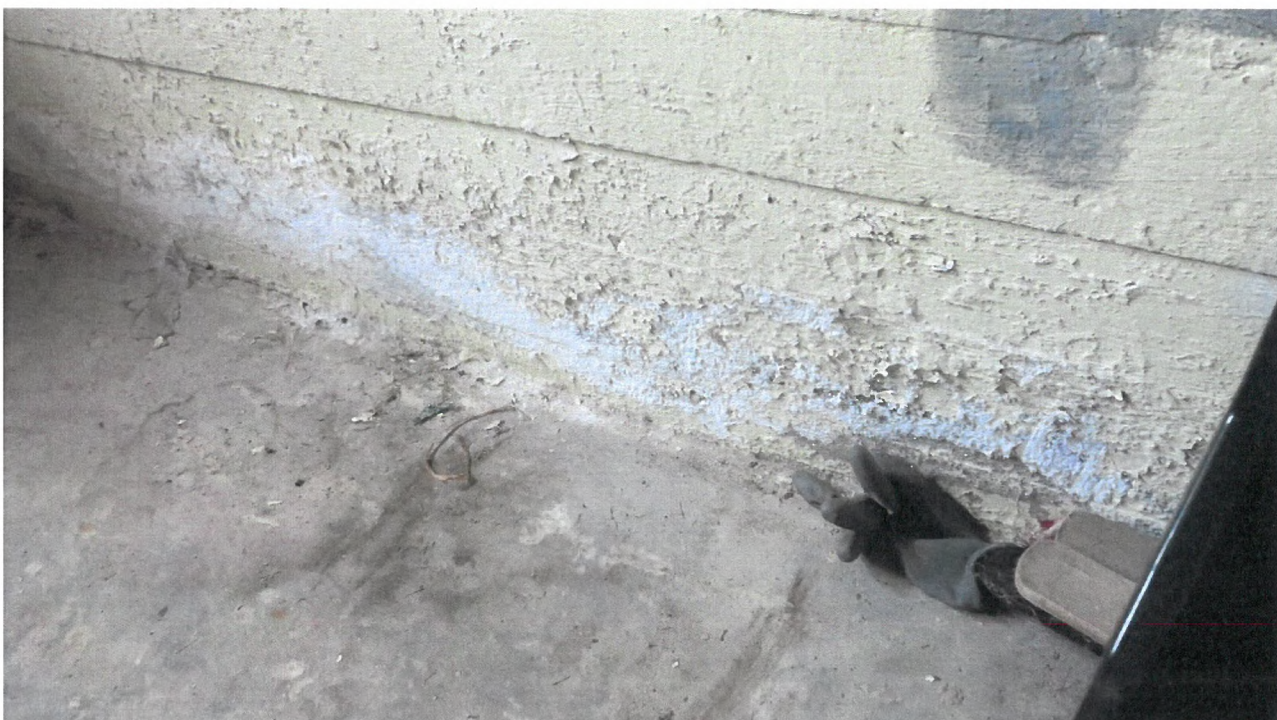
Foto 18: Fra kjeller i nr. 66-72. Typisk tegn på fuktoppsug i nedre del av kjelleryttervegg. Det gir avflaking av maling og noe kalkutfelling. Selve veggkonstruksjonen av betong skades ikke av dette.
