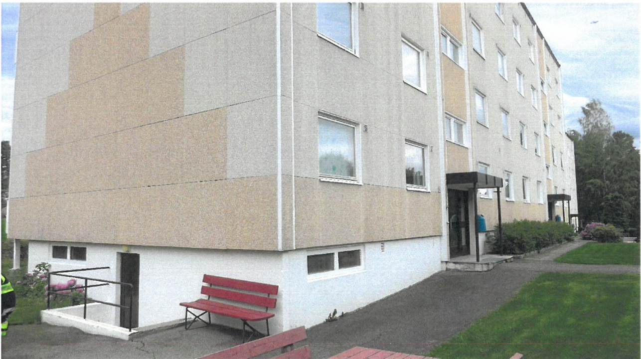
Foto 16: Bølerlia 66-72, sett fra sør. Vi ser langfasaden mot øst. Det er beplantning utenfor deler av fasaden. Terrenget utenfor dette ser ikke ut til å ha fall inn mot bygningen.
