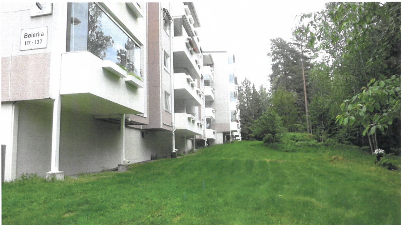
Foto 2: Bølerlia 117-125, her langfasade mot sør (mot "skogen"). Her heller terrengoverflaten inn mot sokkel. Det er uheldig. Det gir økt vannpåkjenning på utsiden av kjellerveggene og inn under gulv.
