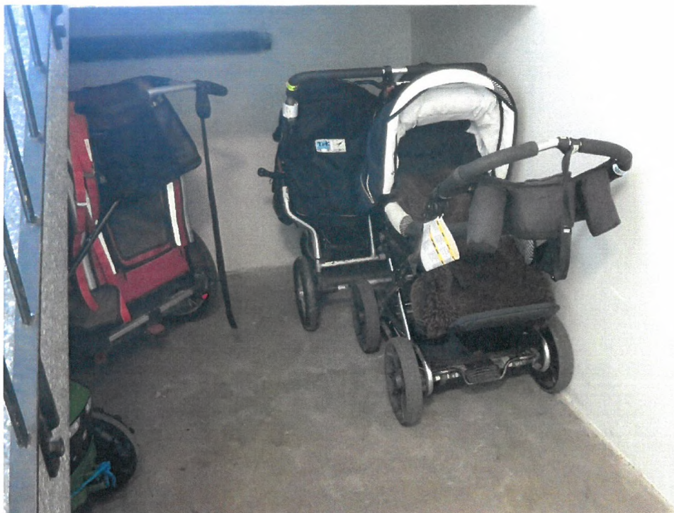
Foto 23: Fra et av trapperommene hvor det fremsto som fuktig i nedre deler av vegg og på gulv. Med fuktindikator registrerte vi at nedre del av vegger her er fuktige. Det er montert stråleovn på veggen under trappa. Det er gunstig.
