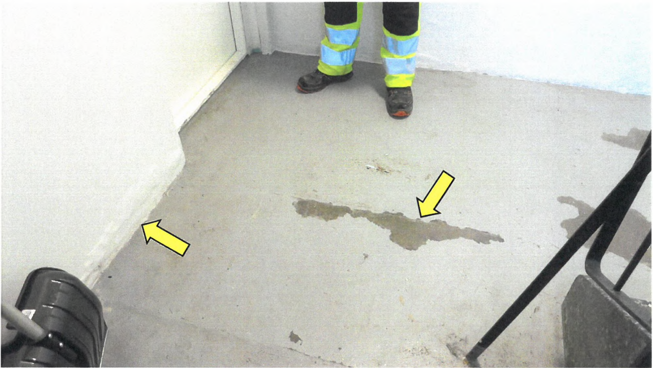
Foto 7: Trapperom som nylig er pusset opp. Vi ser tegn til at malingen på nytt flaker av på nedre del av vegg i gulv.
