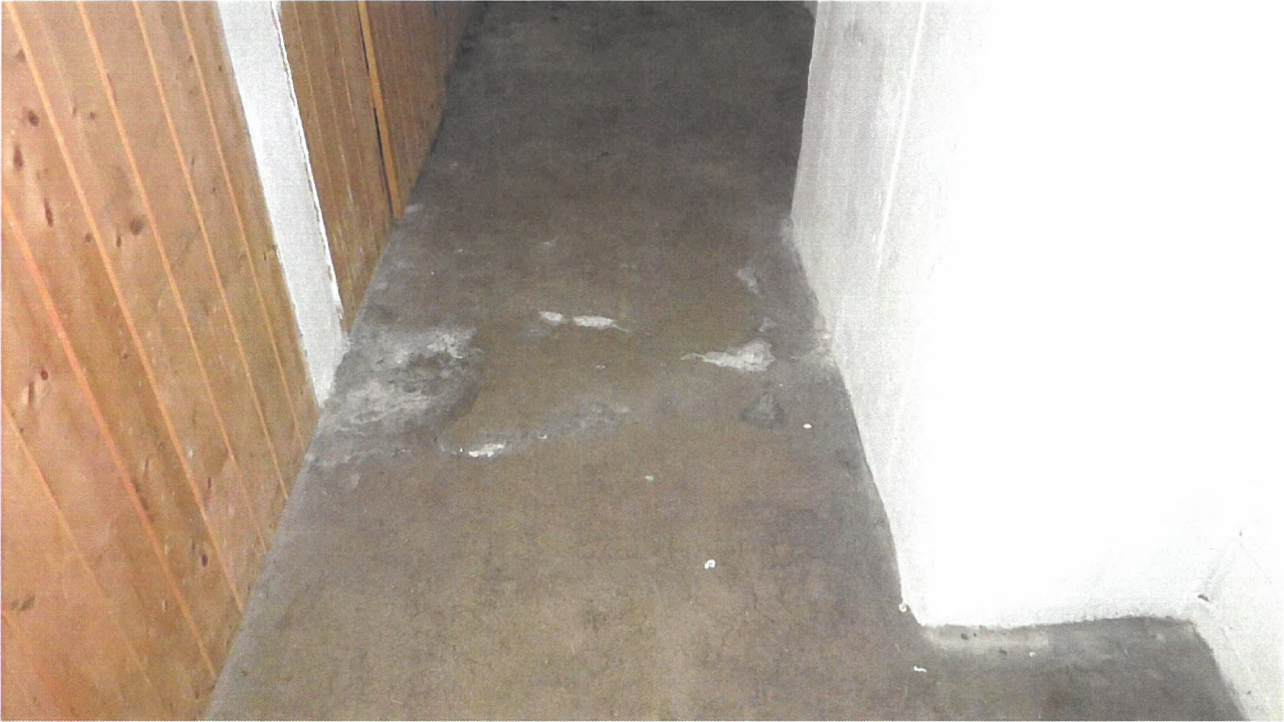
Foto 5: Fra kjeller i 117-125. Typisk bilde. Enkelte lokale symptomer på noe fuktoppsug fra grunnen (kalkutslag på gulvet og i nedkant på betongvegg).
