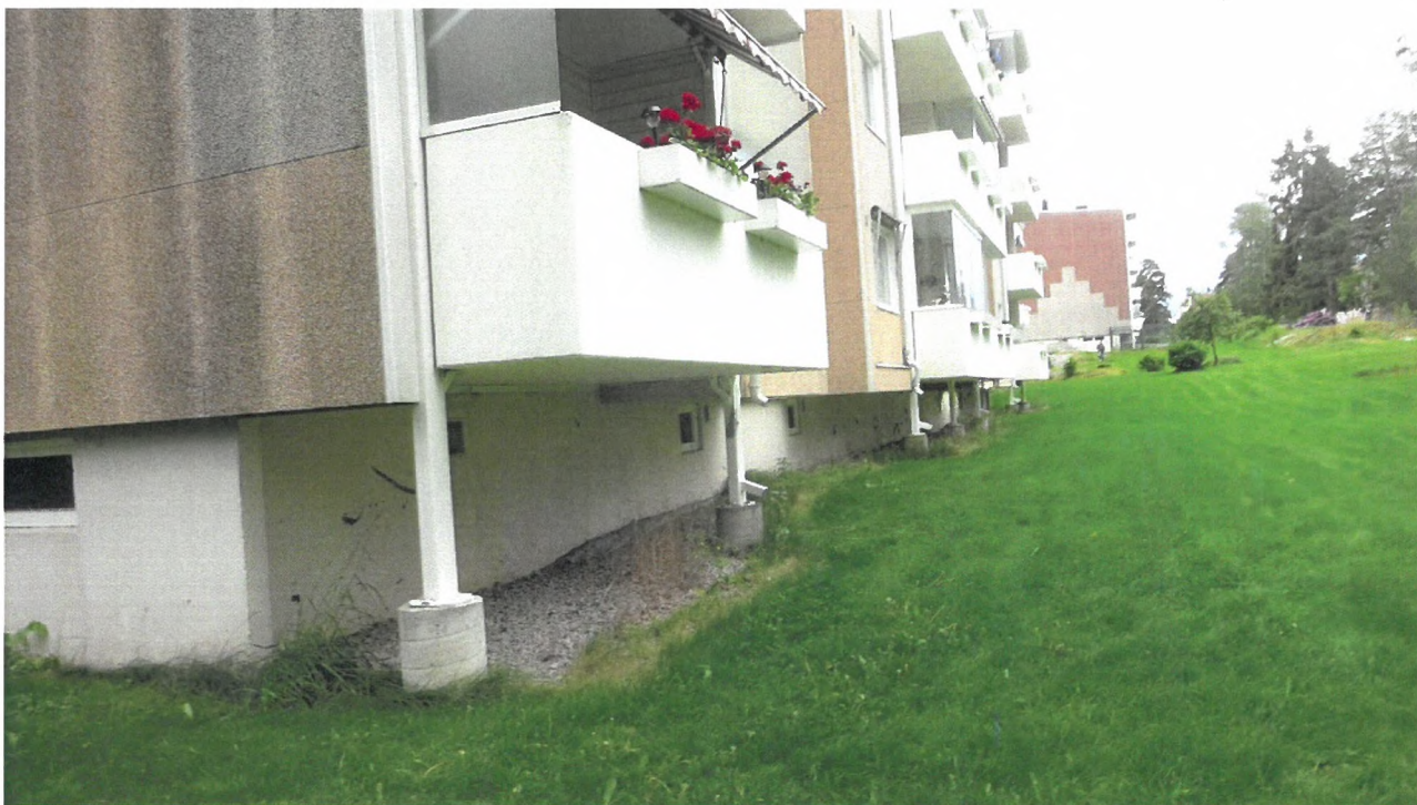
Foto 17: Langfasade mot vest i Bølerlia 66-72 (dette er utenfor 72). Terrengoverflaten heller inn mot bygningen. Det er uheldig med tanke på alt overflatevann som finner veien inn mot kjellervegg og i byggegrunnen under bygningen.
