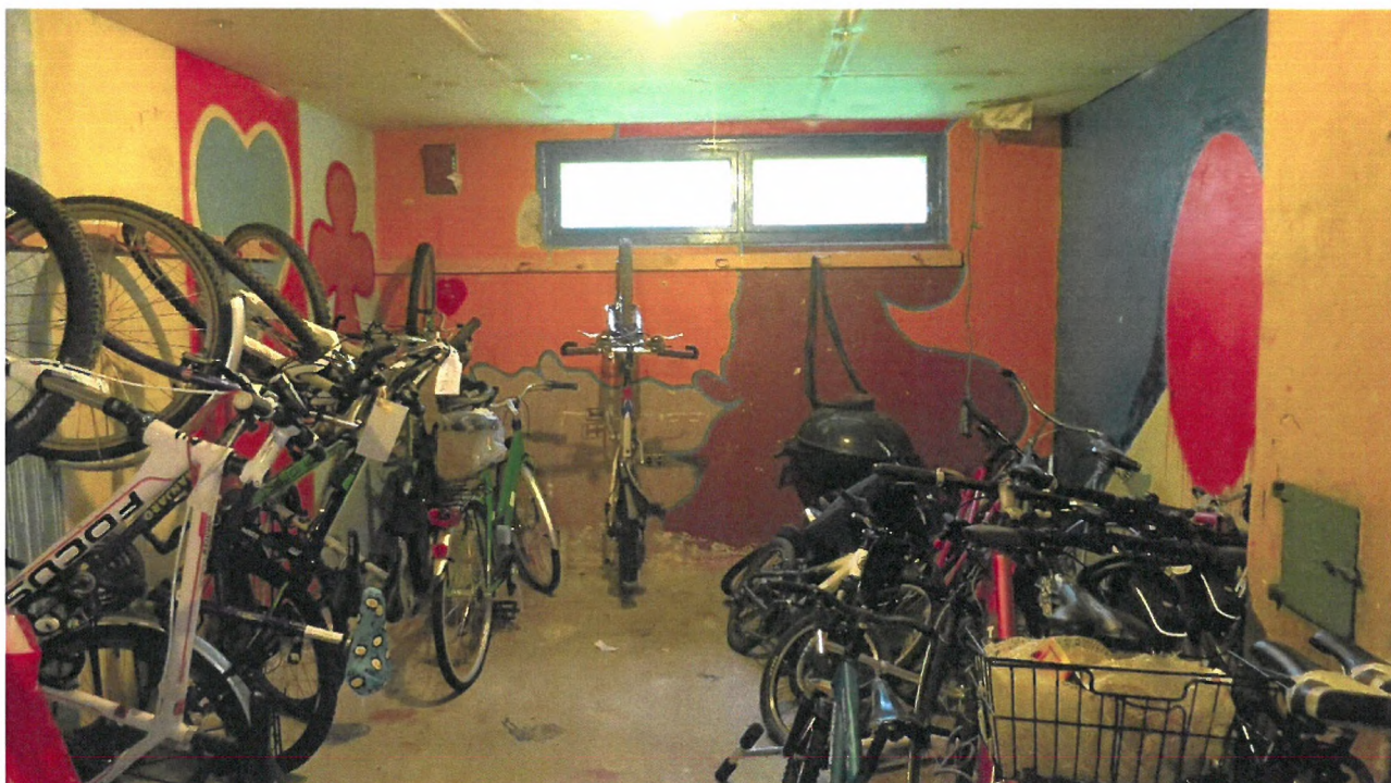
Foto 12: Sykkelbod i Bølerlia 127-131. Dette er fra sørenden av kjelleren. Tydelige symptomer på fuktinntrengning i overgang vegg/gulv. Se neste foto.
