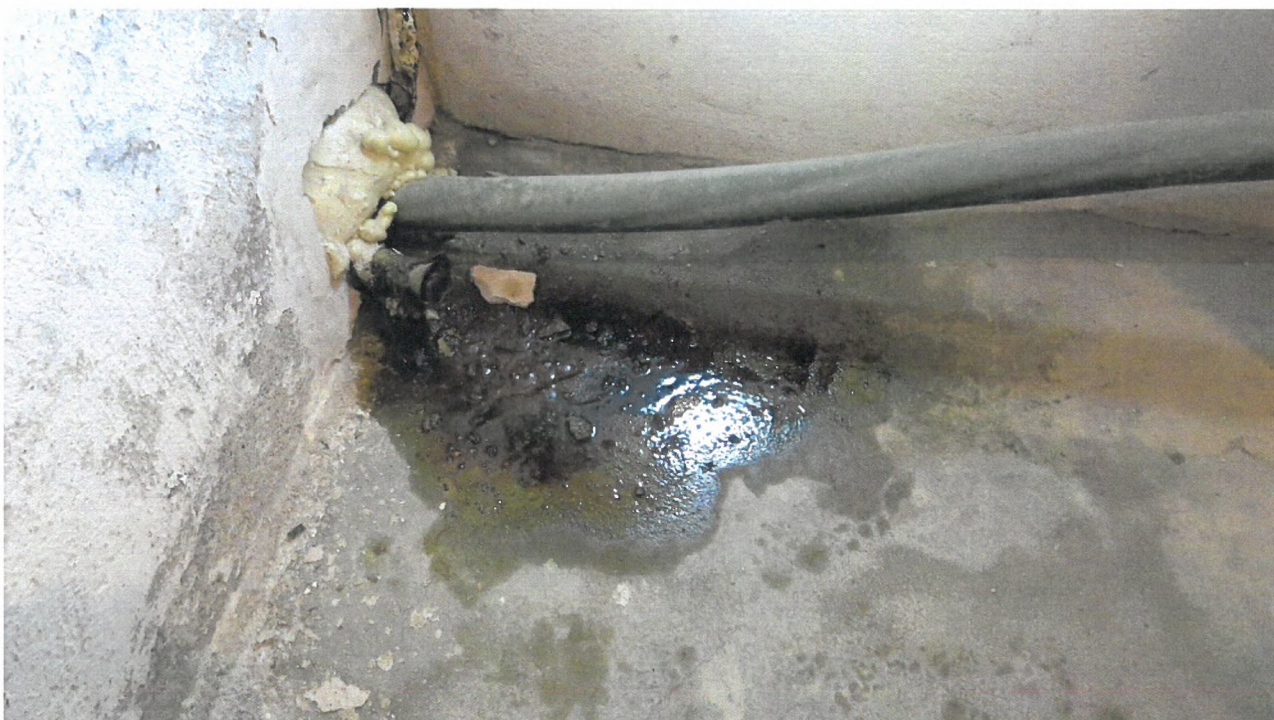
Foto 20: Fra kjeller i Bølerlia 66-72. I et av rommene ("teknisk rom") er det vannlekkasje i forbindelse med ny kabelgjennomføring i kjellervegg. Det er forsøkt tettet med fugeskum.
