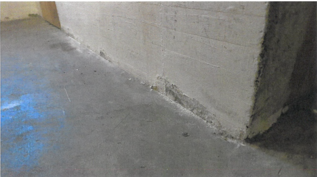
Foto 6: Fra kjeller 117-125. Typisk tegn på kapillært fuktoppsug i vegg. Ingen skadefare for konstruksjonen, men gir avflaking av maling og noe kalkutfelling.
