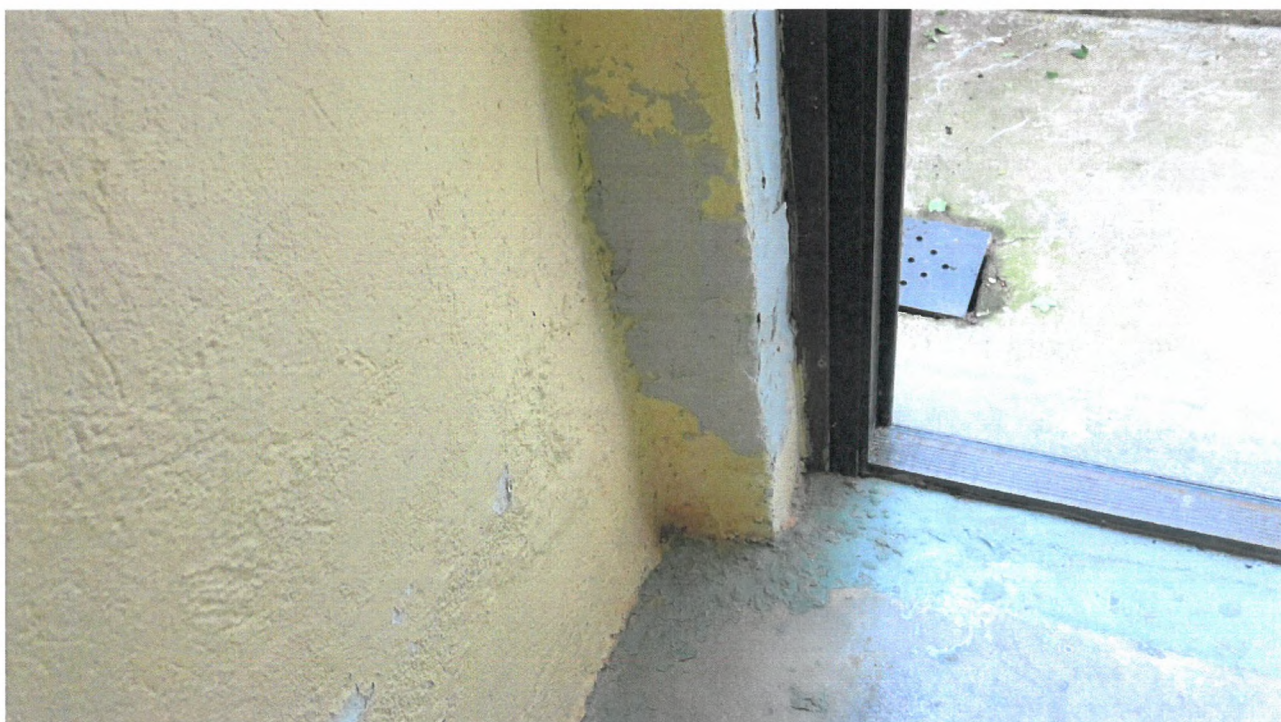
Foto 24: Fra en av kjellerutgangene i blokken 66-72. Sluket på utsiden av døra er eneste dreneringsmulighet for vann som renner ned den utvendige kjellertrappa. Det kan fort tilstoppes av skitt. Liten terskelhøyde for vann gir stor risiko for vann inn på kjellergulvet. Slike sluk må inspiseres og rengjøres regelmessig.
