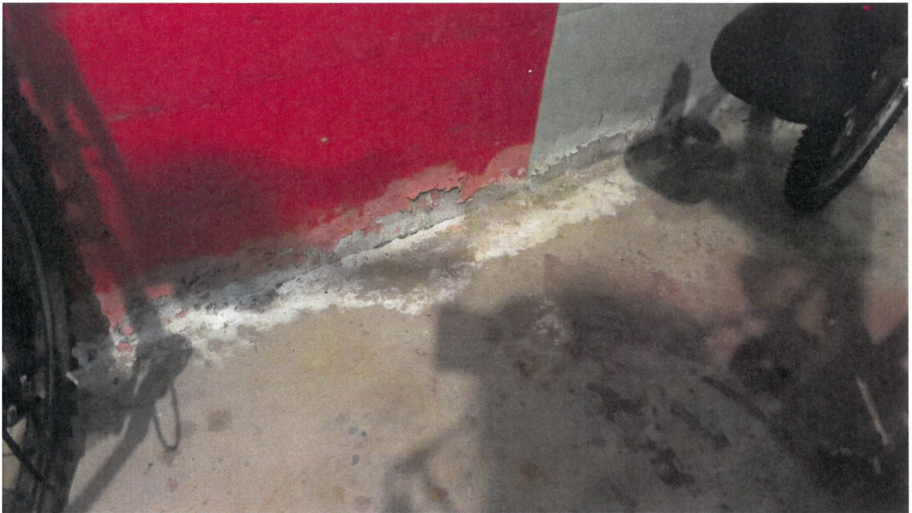
Foto 13: Fra samme sykkelbod. Her er det kraftige tegn på fuktinntrengning i overgang yttervegg/gulv.
