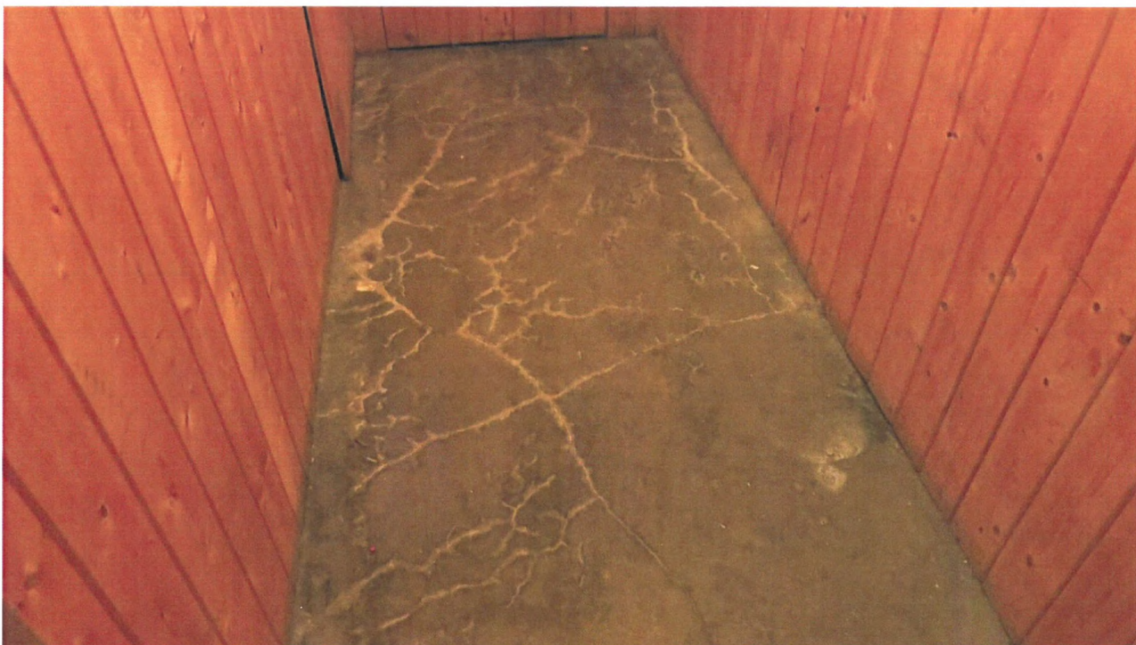
Foto 21: Typisk bilde av kjellergulvet i deler av denne kjelleren. Kalkutslag viser at det i perioder er fuktoppsug i gulvet.
