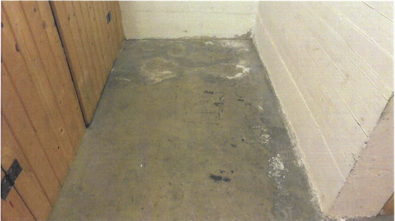
Foto 15: Fra samme kjeller. Typisk tegn på fuktopptrekk i gulvene, med noe kalkutfelling. Trekonstruksjonene har ikke synlige skader.
